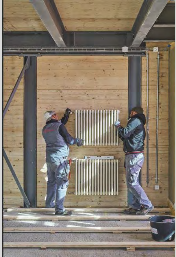
Réemploi de radiateurs dans l'extension d'un bâtiment industriel Source : Opalis ; Architecte : Baubüro in situ
