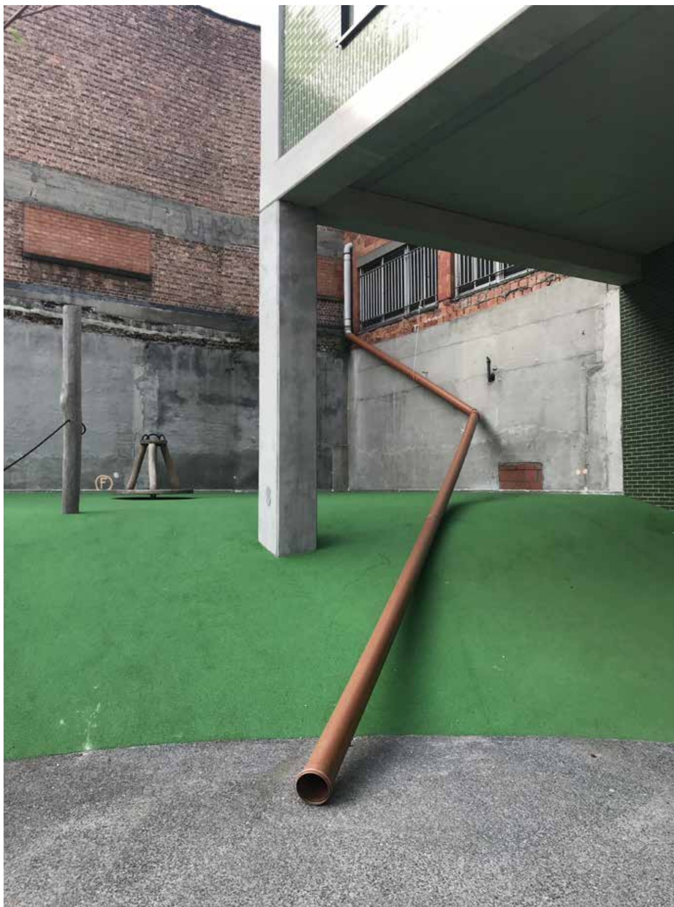
Photo prise le 27 juin 2023, dans l'espace en intérieur d'îlot « La Grande Halle », Quai de l'Industrie 79 à Molenbeek. Foto genomen op 27 juni 2023, in het interieur van het blok «Grote Hal», Nijverheidskaai 79 in Molenbeek.
