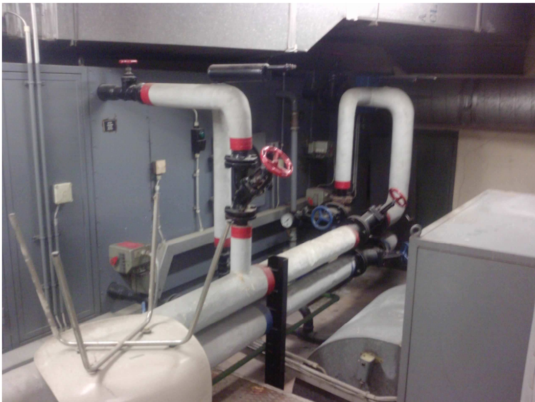
Crèche Reine Fabiola, -1, calorifugeages des tuyaux photo 2
