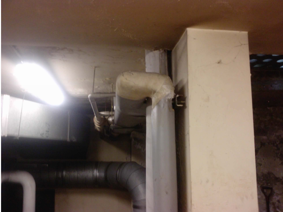
Crèche Reine Fabiola, -1, calorifugeages des tuyaux photo 3
