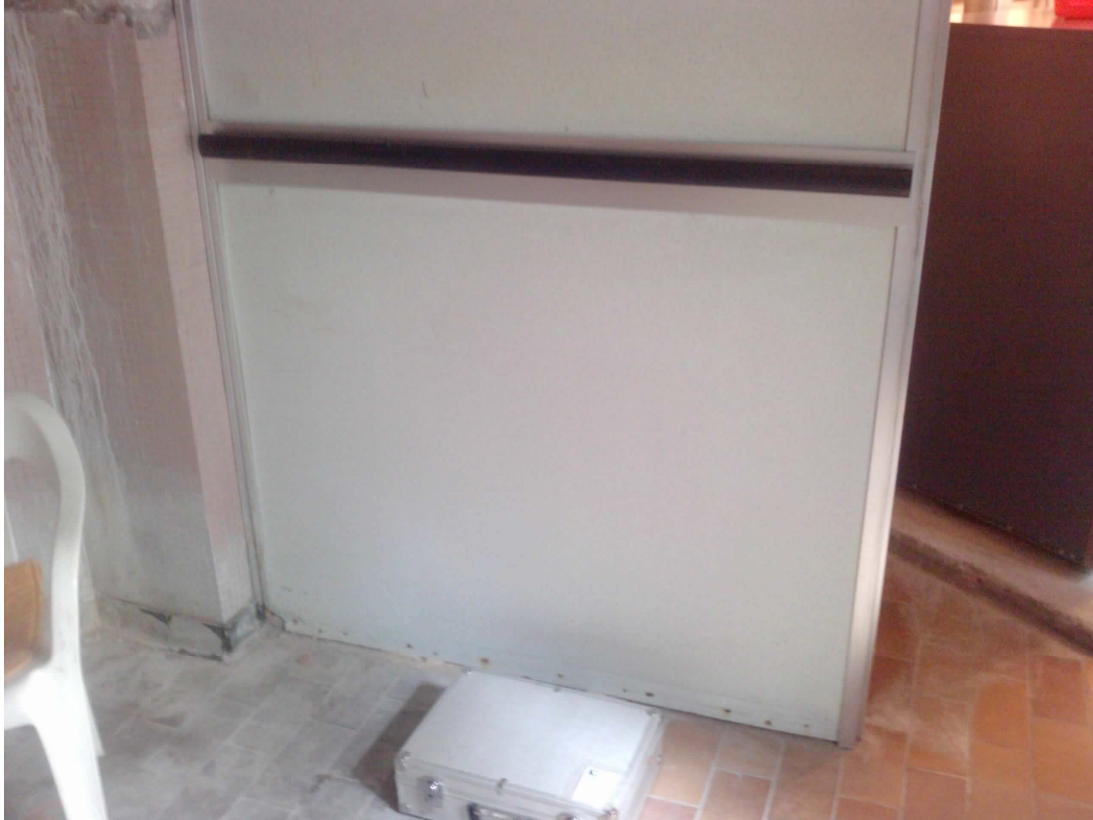
Crèche Reine Fabiola, cloisons de séparation des différentes pièces en asbeste-ciment photo 1
